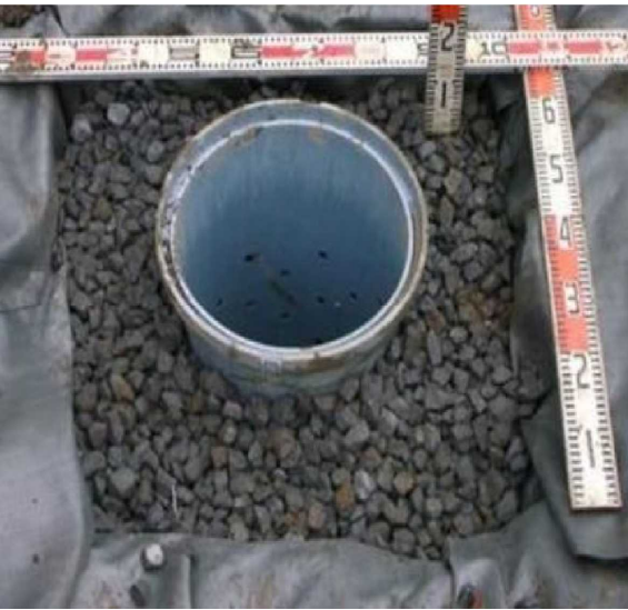
宅地内 雨水浸透ます
