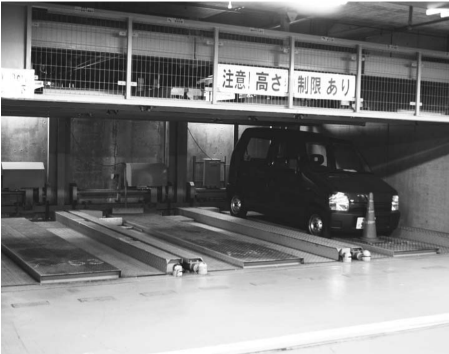
狛江駅北口地下駐車場（機械式）
